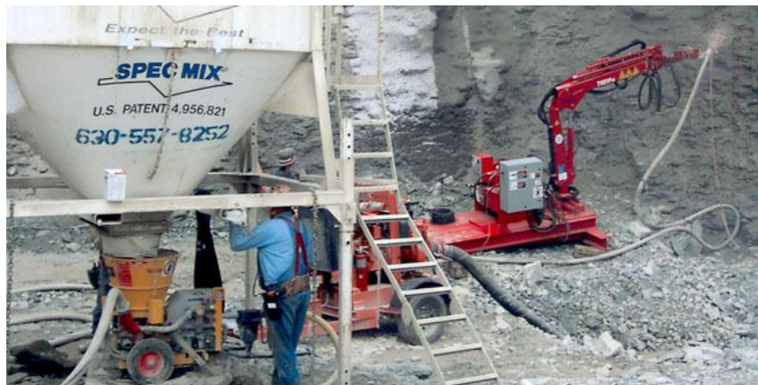
Fotografía 2. 7 Utilización de concreto lanzado para recubrimiento en túneles usando robot para su aplicación.
