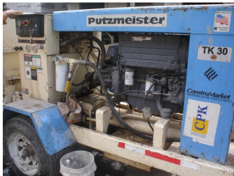
Fotografía 6. 2 Equipo de Lanzadora de mezcla húmeda
