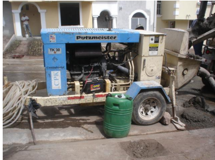
Fotografía 6. 1 Equipo de Lanzadora de mezcla húmeda
