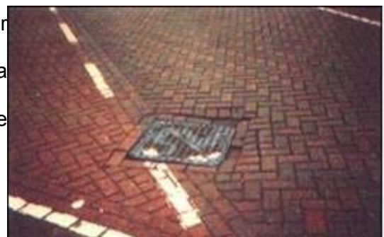
Figura I.P Tipo de Drenaje Sumidero
