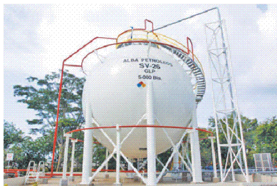
La planta de almacenamiento de combustible de Alba Petróleos está en Acajutla. FOTO EDH / ARCHIVO
