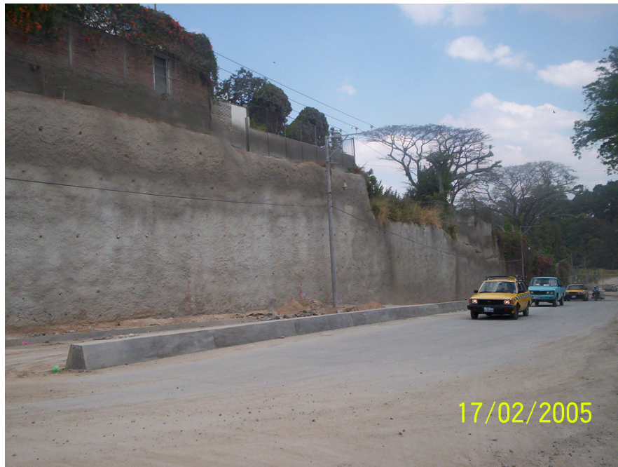
Fotografía N° 9: Muros que restringieron el alineamiento horizontal.
