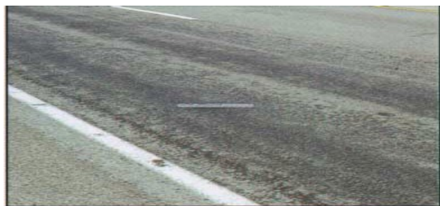
Figura 4.24. Exudación de Asfalto 131 .
