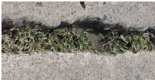
Figura 3.27. Deficiencias en material de sello. 103
