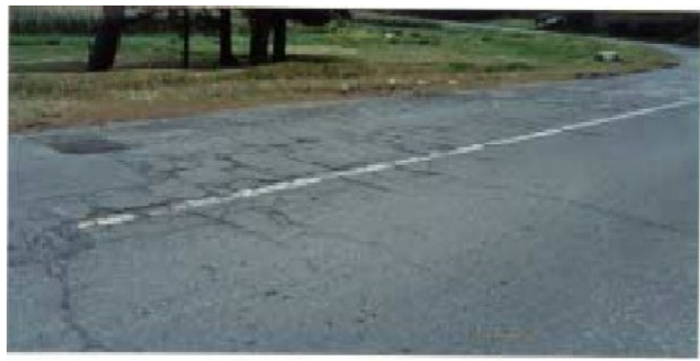
Figura 4.11. Fisura en Bloque 118 .
