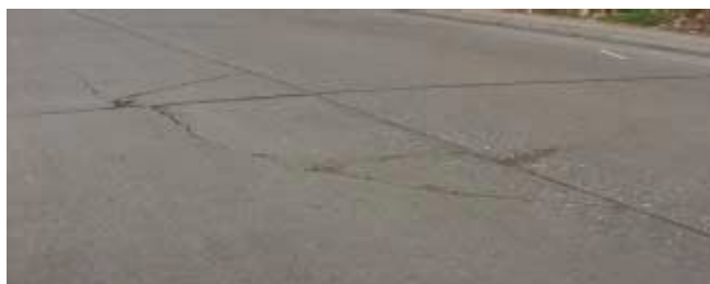
Figura 3.16. Fisura de esquina. 90
