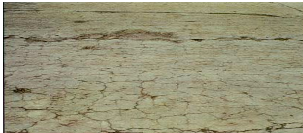
Figura 3.18. Fisura en bloque. 93
