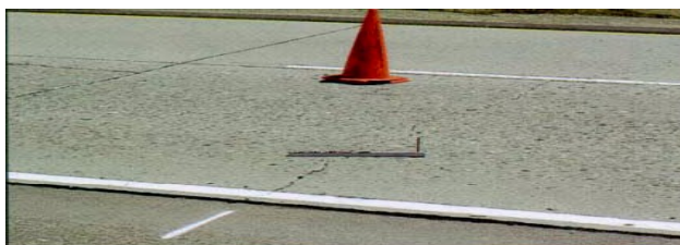
Figura 3.14. Fisura transversal o diagonal. 88
