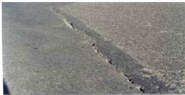
Figura 4.15. Fisura por reflexión de Junta 122 .
