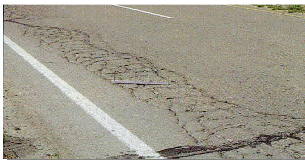
Figura 4.10. Fisura Piel de Cocodrilo 117 .
