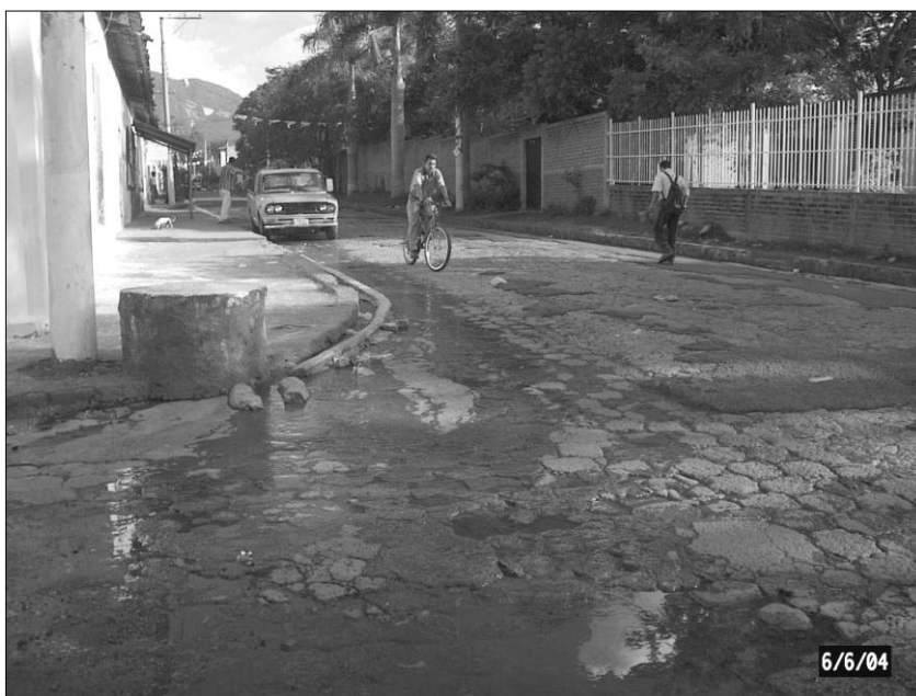
Figura 1.2. Calle principal de la Ciudad de Turín, en donde se observan las aguas residuales que corren permanentemente por las cunetas de las calles.
