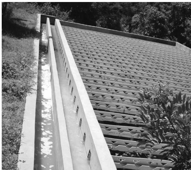
Figura 58. Filtro percolador biológico.
