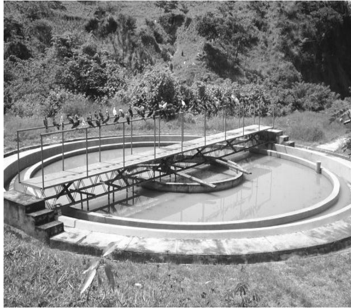
FIGURA 37. Tanque sedimentador primario tipo Dortmund.
