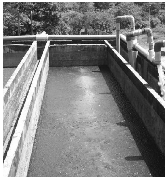
FIGURA 50. Tanque Imhoff (Tubería descargando el agua residual en la cámara de sedimentación).
