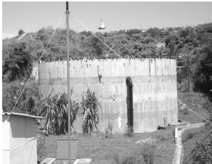
FIGURA 35. Filtro percolador biológico.
