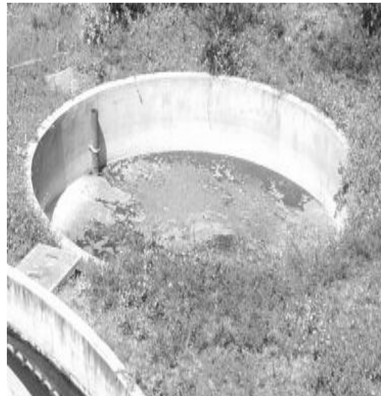
Figura 60. Tanque sedimentador secundario Tipo Dortmund # 2
