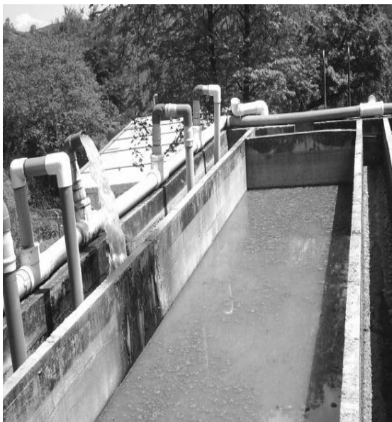
FIGURA 49. Tanque Imhoff (Tubería descargando el agua residual en la cámara de gases y natas y en la cámara de sedimentación).
