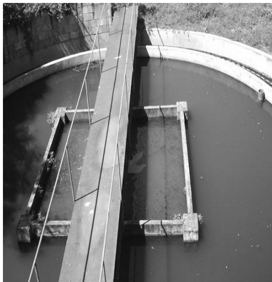
Figura 59. Tanque sedimentador secundario Tipo Dortmund # 1
