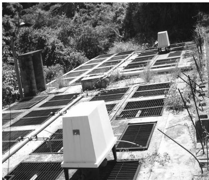
Figura 63. Tanques de lodos activados.
