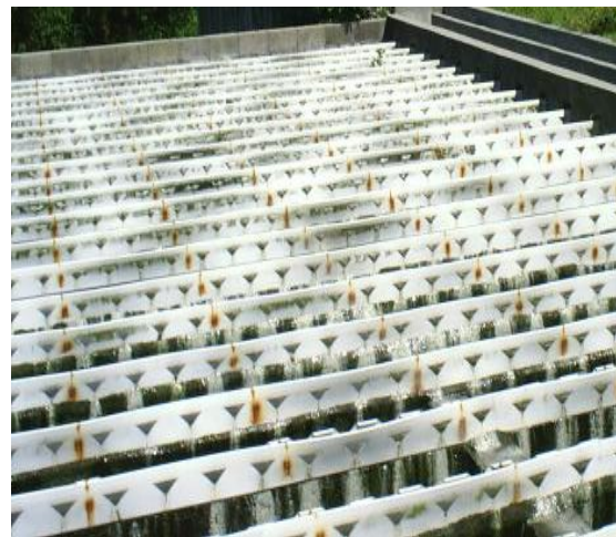
Figura 79. Filtro percolador con canaletas de PVC.
