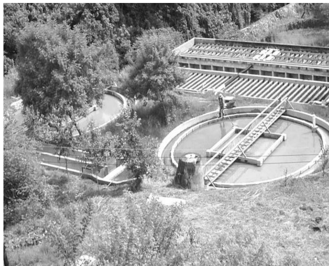
FIGURA 25. Tanques sedimentadores primarios tipo Dortmund.
