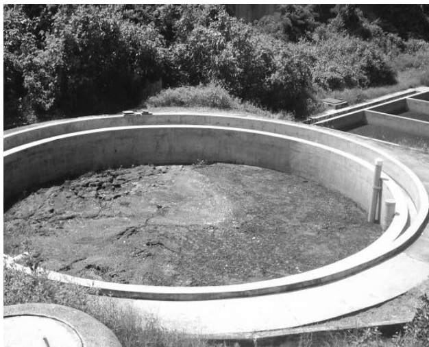
FIGURA 43. Digestor de lodos.
