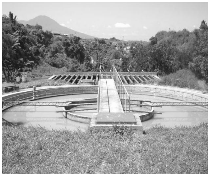
FIGURA 36. Tanque sedimentador primario tipo Dortmund.
