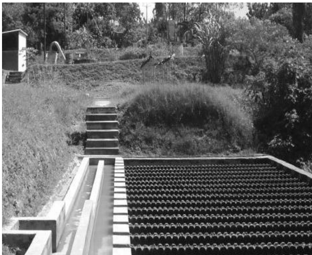
FIGURA 39. Filtro percolador biológico.
