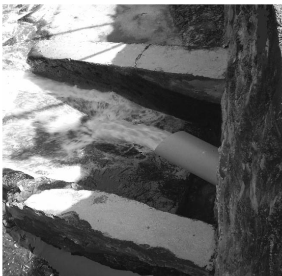
FIGURA 30. Descarga del agua residual tratada al cuerpo receptor.
