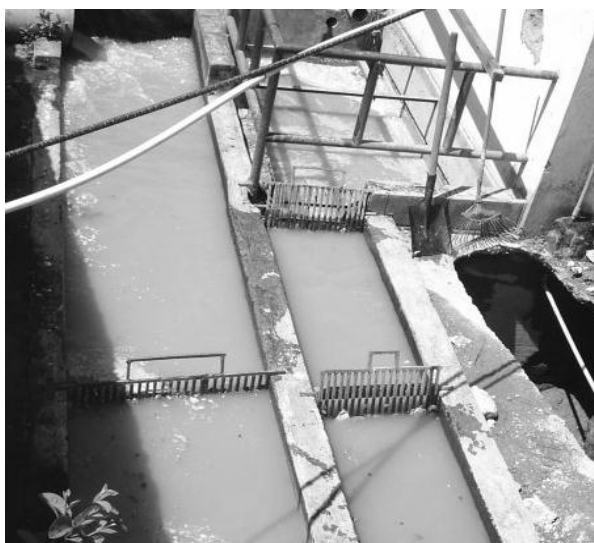
FIGURA 48. Rejillas y canales.
