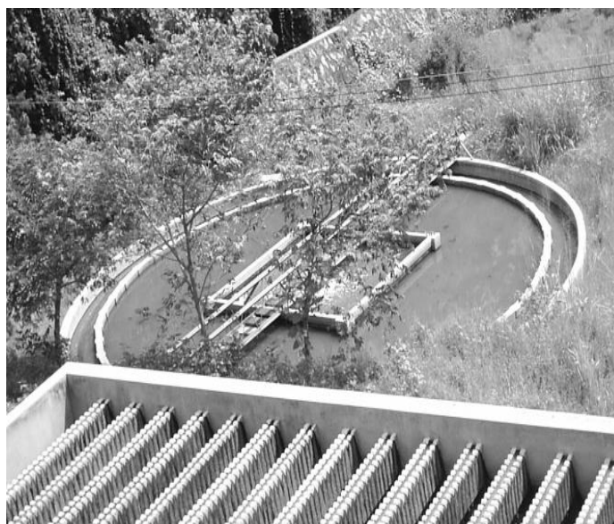
FIGURA 27. Tanque sedimentador secundario tipo Dortmund.
