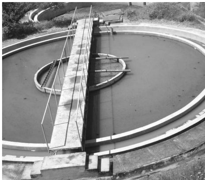
FIGURA 41. Tanque sedimentador secundario tipo Dortmund.
