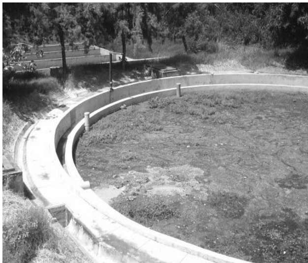
FIGURA 42. Digestor de lodos.
