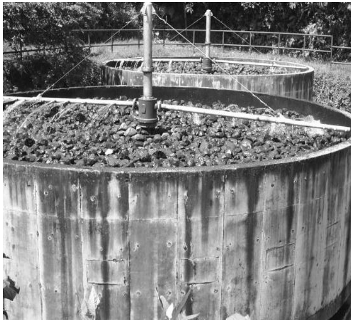
FIGURA 51. Filtros percoladores biológicos.
