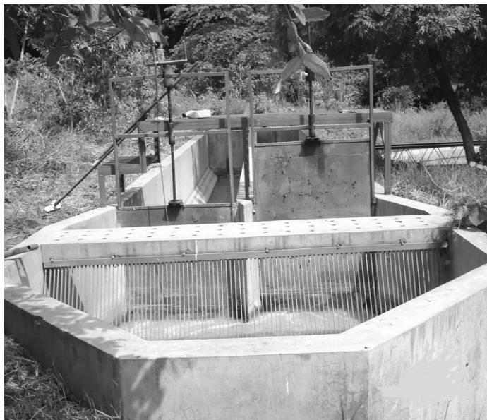
FIGURA 24. Canal con rejillas, desarenador y Parshall.
