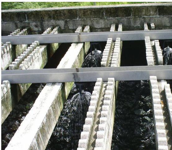
Figura 78. Filtro percolador con canaletas de Aluminio.
