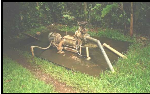
Figura 1.1a Pozo y Cisterna
