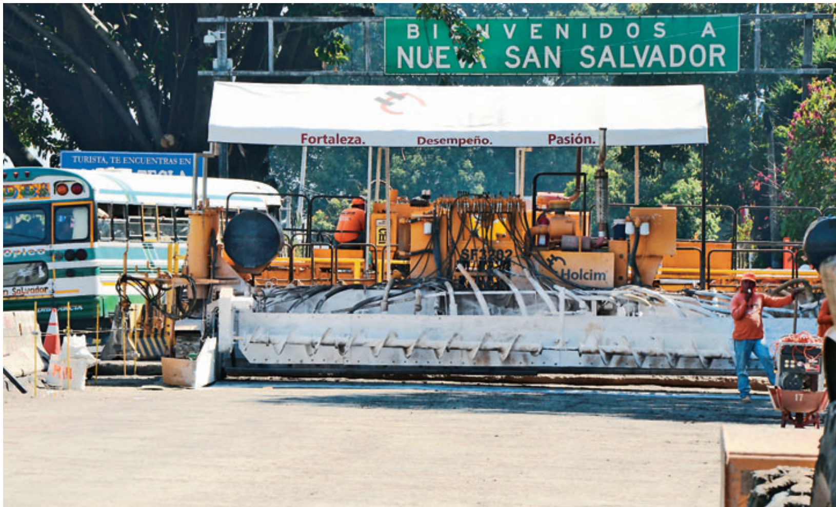
El equipo especializado que aplicará el concreto a la base ya se encuentra en la zona, listo para iniciar hoy. FOTO EDH / SEBASTIÁN SUÁREZ
