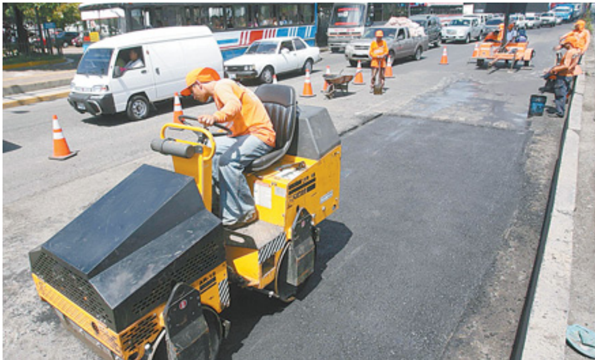
Preparativos. En el tramo de carretera conocido como Los Chorros se coloca la base previo al concreto hidráulico, una de las labores más tardadas.
