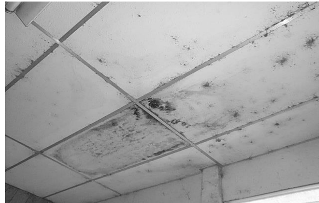
Fig. 3.26 Daños en losetas por humedad.
