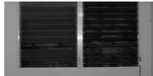
Fig. 3.34 Daño de una ventana
