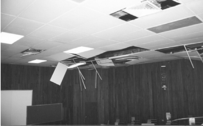
Fig. 3.25 Caída de losetas y riostrado metálico.
