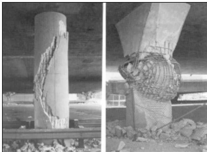
Figura 3.20 Ejemplos de fallas por cortante en columnas, terremoto de Northridge de 1994.
