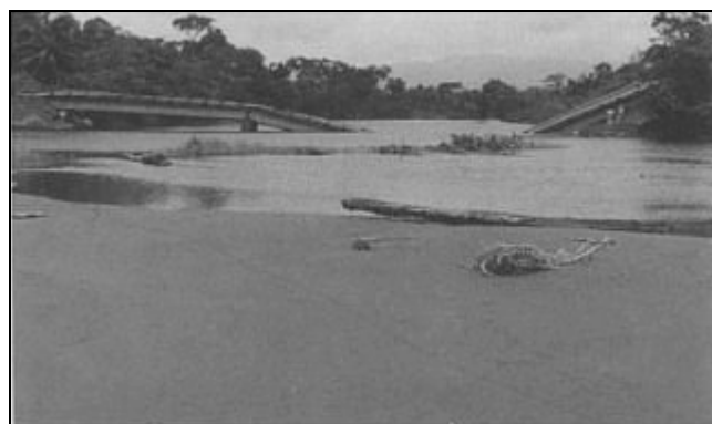
Figura 3.4 Falla por licuefacción, puente de Río Vizcaya, terremoto de Costa Rica 1990.
