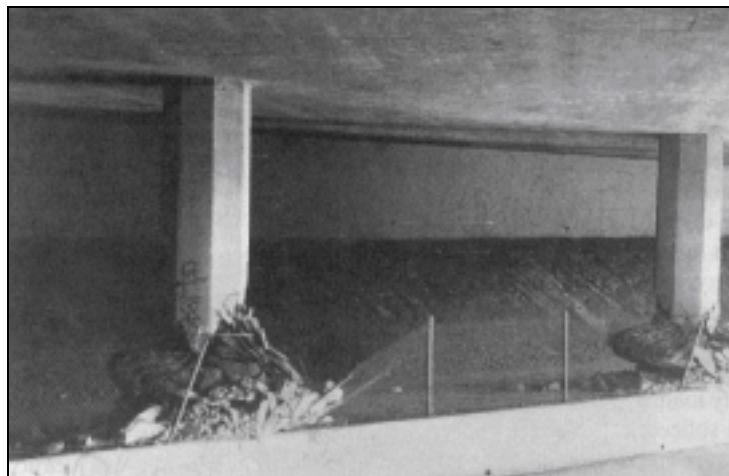
Figura 3.14 Rótulas plásticas falladas en columnas, terremoto de Northridge de 1994.
