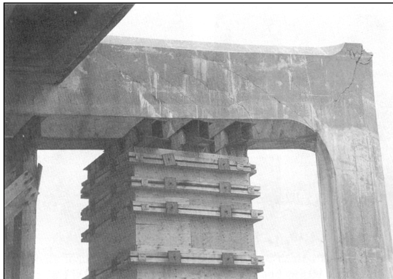
Figura 3.21 Fallas por flexión y cortante en viga cabezal y nudo, viaducto China Basin, terremoto de Loma Prieta de 1989.
