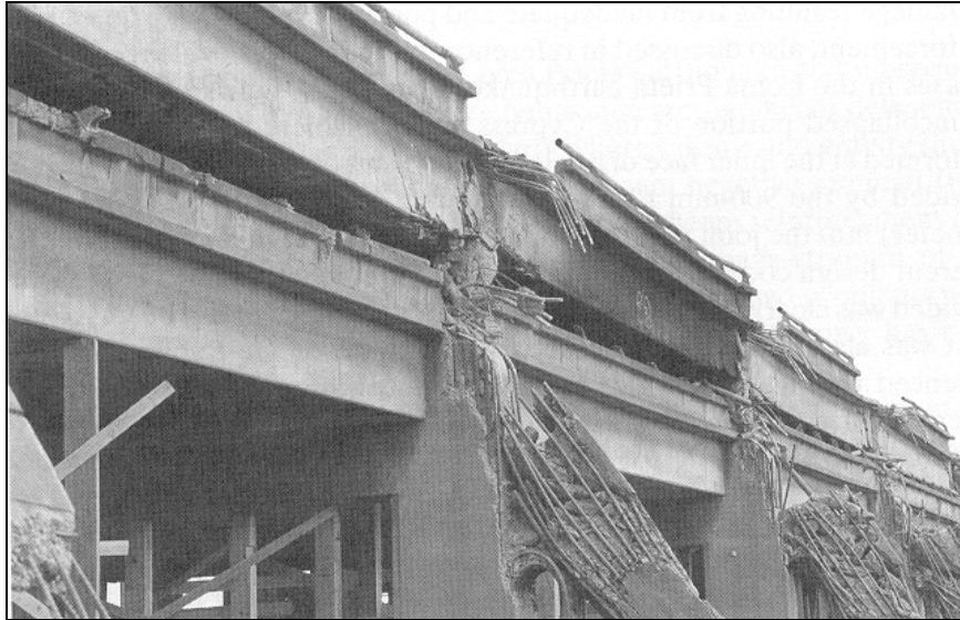
Figura 3.23 Falla en el anclaje del refuerzo de la viga cabezal viaducto Cypress, terremoto de Loma Prieta de 1989.
