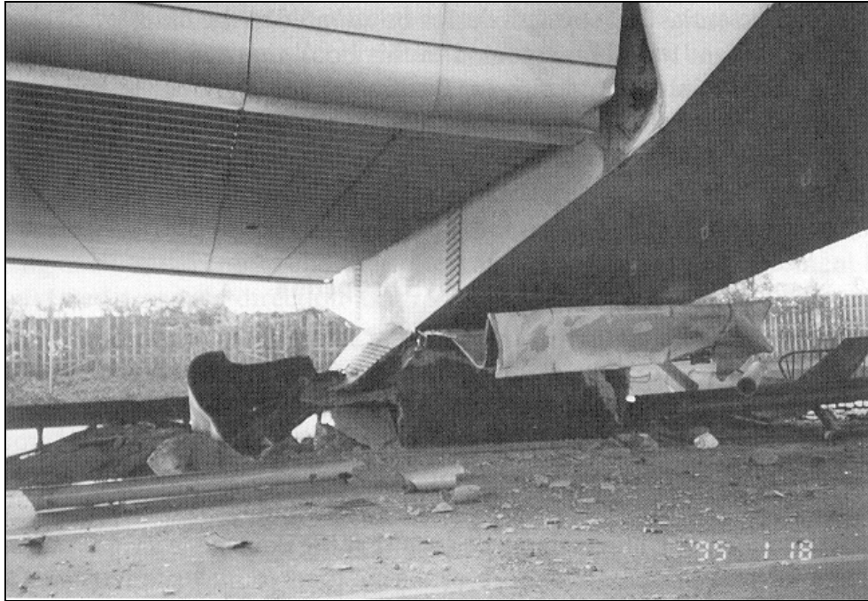
Figura 3.28 Colapso de columna de acero, terremoto de Kobe de 1995.
