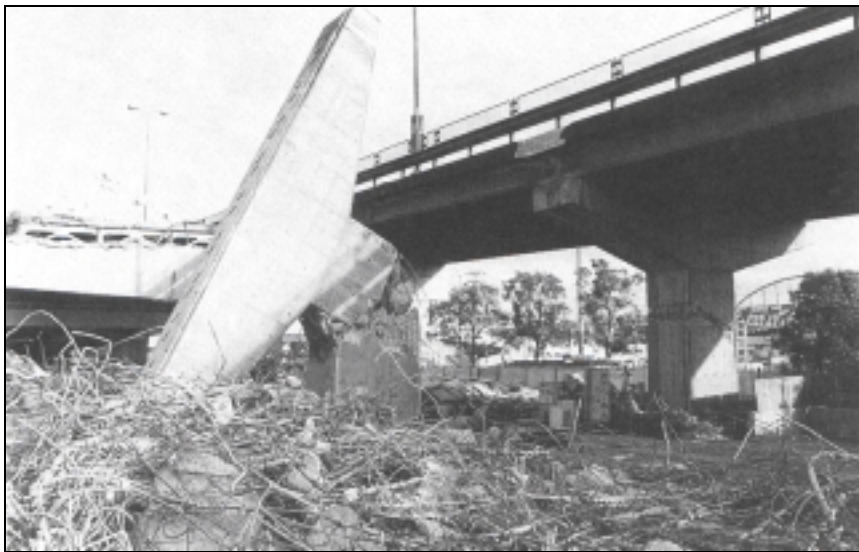
Figura 3.15 Falla de flexión-cortante a media altura de la pila debido a la terminación prematura del refuerzo longitudinal; terremoto de Kobe de 1995.
