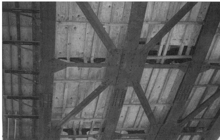
Figura. 2.6 Arriostramiento lateral sobre un puente de vigas compuestas de acero, curvado horizontalmente.
