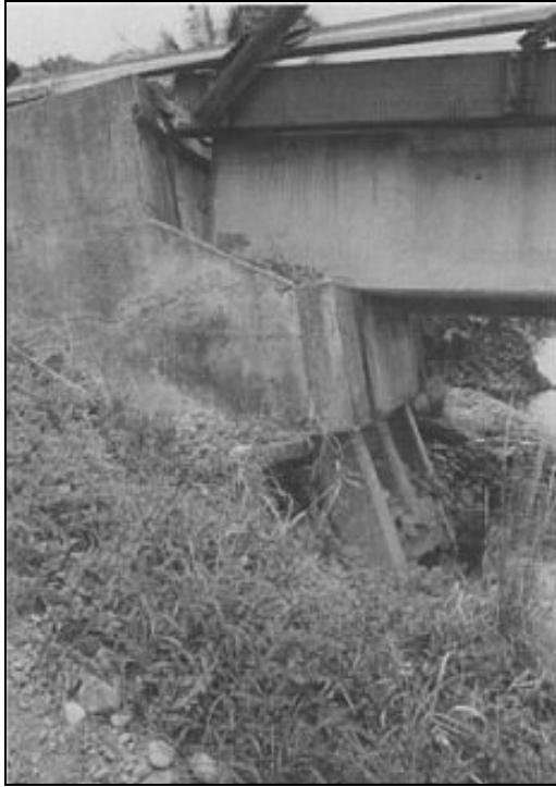
Figura 3.9 Falla por asentamiento y rotación de estribo. Puente Río Banano, Terremoto de Costa Rica 1990.
