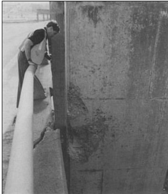
Figura 3.7 Golpeteo de viaducto I-280 China Basin/Southern, terremoto de Loma Prieta 1989.
