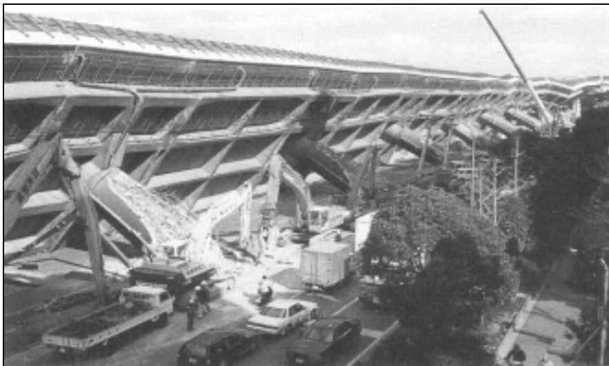
Figura 3.16 Falla de flexión sobre la base de las columnas de la Autopista Hanshin, debido a la terminación prematura del refuerzo longitudinal y a inadecuado confinamiento; terremoto de Kobe de 1995.
