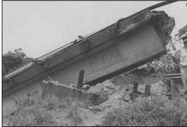
Figura 3.10 Estribo fallado debido a una presión pasiva, puente Río Vizcaya, terremoto de Costa Rica 1990.
