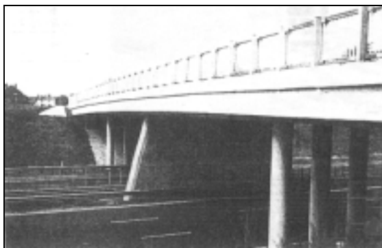
Figura 4.15 Puente con una desagradable mezcla de pilas.
