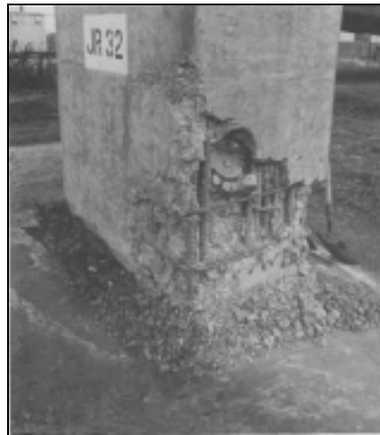
Figura 3.11 Falla de empalmes traslapados en la base de la pila, terremoto de Loma Prieta 1989.
