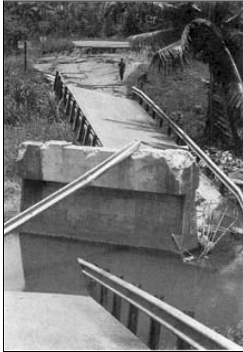
Figura 3.5 Desasiento de claros oblicuos en un sitio con suelo blando, puente Río Bananito, terremoto de Costa Rica 1990.
