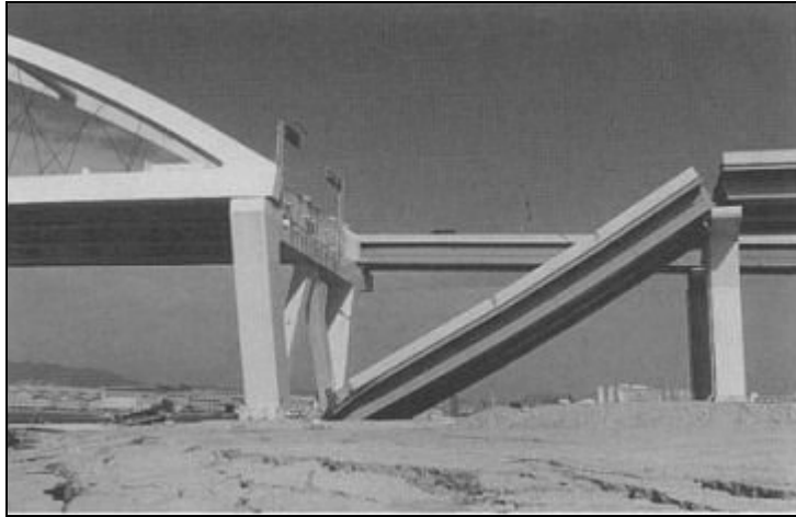
Figura 3.6 Desasiento de un claro simplemente soportado de conexión, puente Nishinomiya-ko, terremoto de Kobe 1995.
