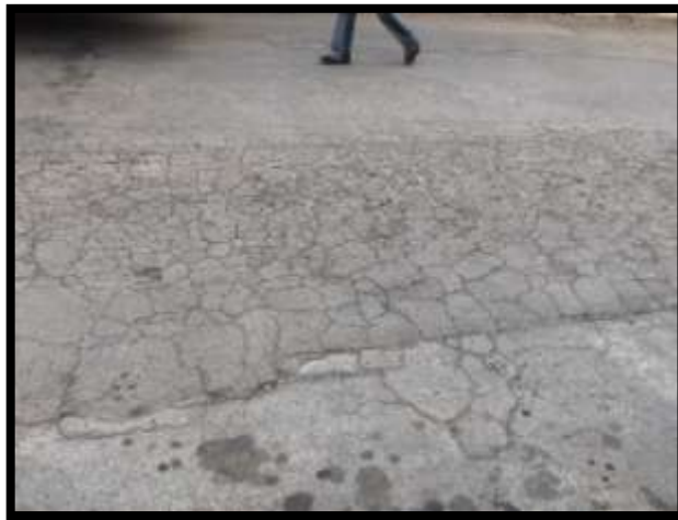
Figura 1.22.- Fisura Piel de Cocodrilo.
