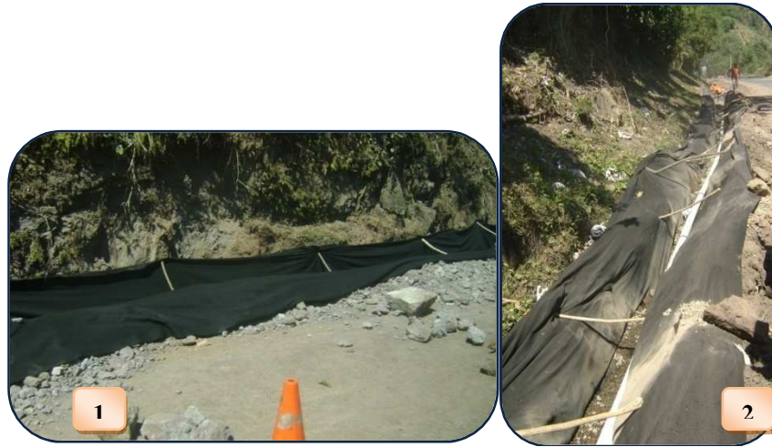
FIGURA 5.4 1. Uso de Geotextil en la evacuación de las aguas de la estructura del pavimento. 2. Tubería para el desagüe de las aguas colocada sobre cama de grava.
