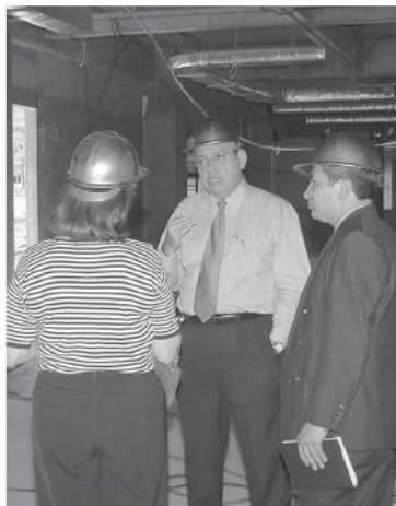
Presidente de la CSJ, Agustín García Calderón escucha a los Ingenieros, los avances de la obra en construcción, le acompaña el Gerente General de Administración, Lic. Oscar Morales.
