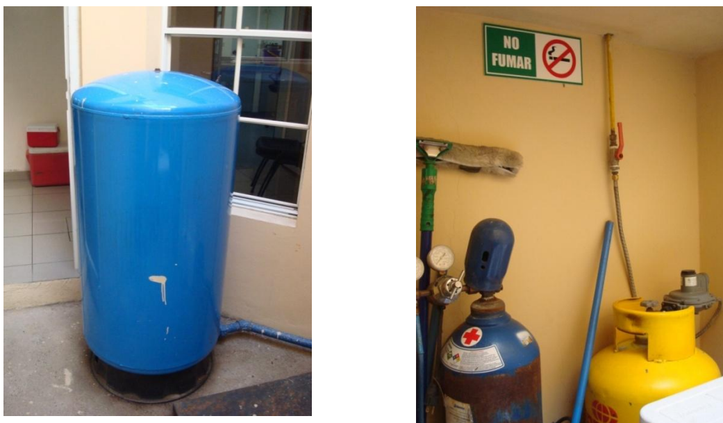
Figura 2.25: Área de cisterna y gas
