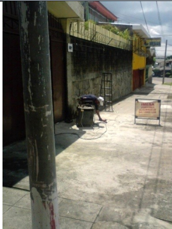
Foto. 13 Riesgos: Eléctricos, Físicos y Mecánicos.
