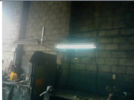
Foto. 34 Riesgos: Eléctricos, Físicos y Mecánicos. La iluminación deficiente y luminarias en mal estado, además de tener las conexiones desordenadas y la pared que no presenta colores claros.
