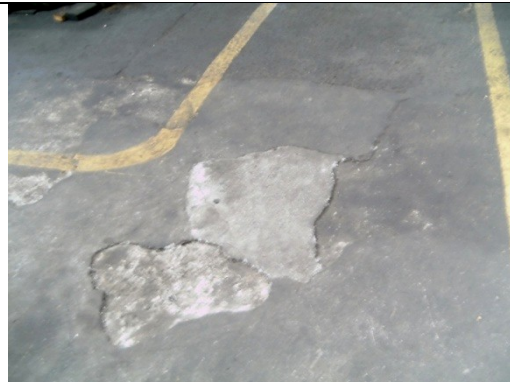
Foto. 30 Riesgos: Físicos y Mecánicos. Pisos de esta empresa con grietas y baches específicamente en los pasillos, lo que genera la probabilidad de accidentes en el personal y en el traslado de materiales u otros procedimientos.
