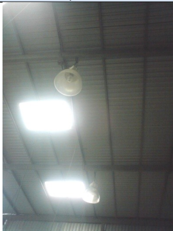
Foto. 15 Riesgos: Eléctrico y Físicos.
