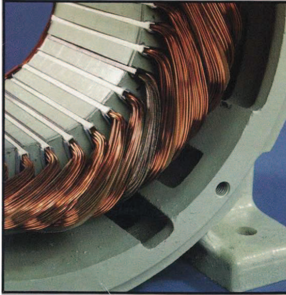
Figura A8.6: Esta es una típica falla en el aislamiento es causado por contaminantes, abrasión y vibración o picos de tensión.
