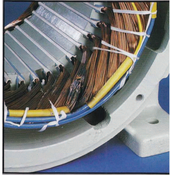
Figura A8.13: Este tipo de fallos en el aislamiento por lo general son causados por sobretensiones. Los transitorios de tensión suelen ser el resultado de los circuitos de conmutación de energía, rayos, descargas de condensadores y dispositivos eléctricos de estado sólido.
