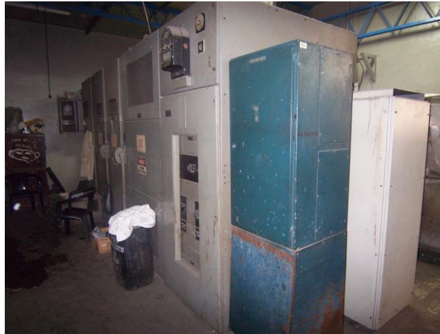
Fig. 4. Subestación en casa de máquinas
