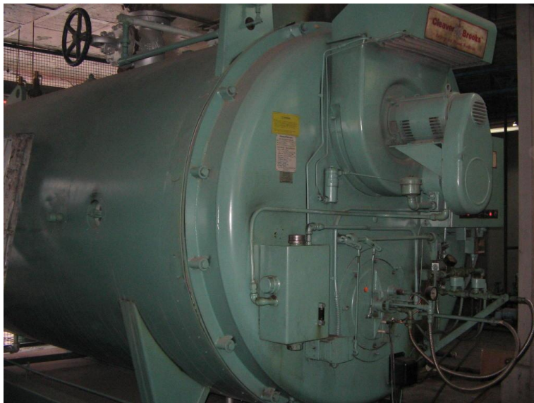
Fig. 5. Caldera de 300 BHP actualmente en línea
