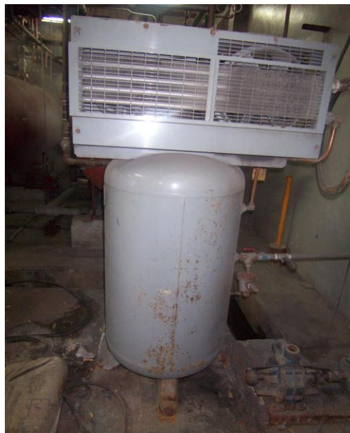
Fig.7. Compresor 2 en casa de máquinas
