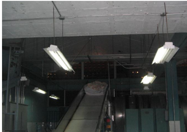
Fig.2 Luminarias en área de recepción y lavado de ropa
