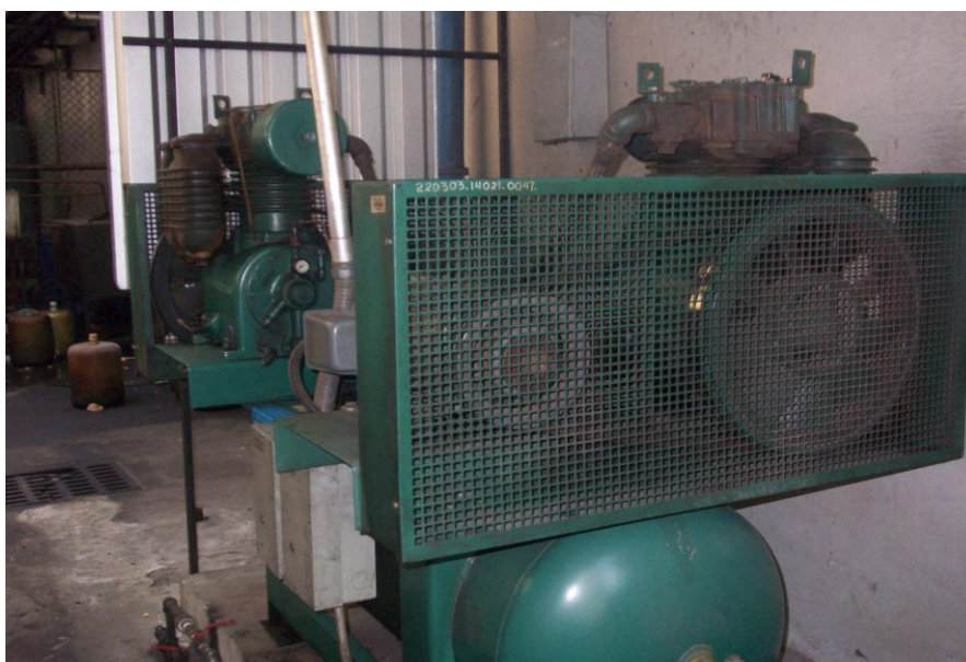
Fig. 8. Compresor 1 en patio de casa de máquinas
