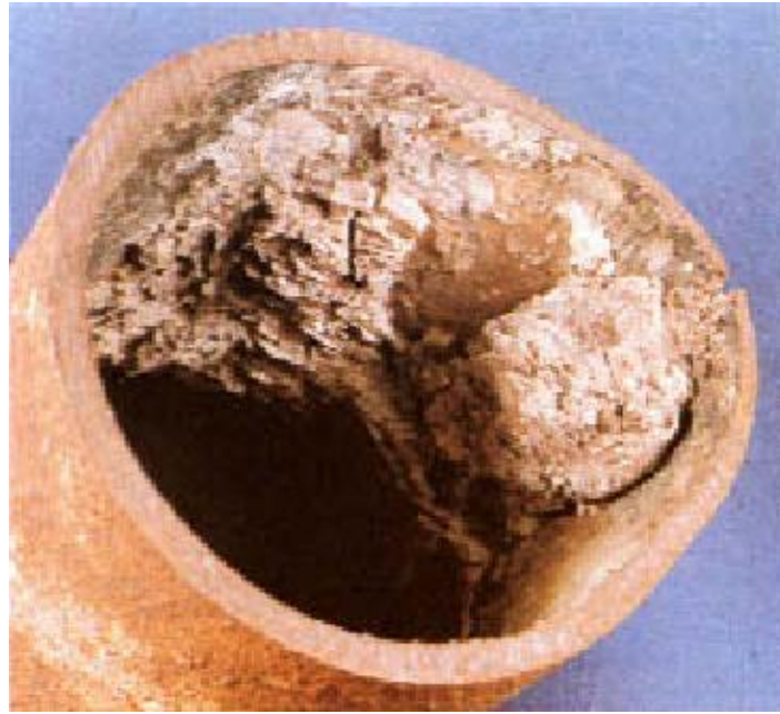
Fig. 19. Hidróxido de Sodio depositado en la pared del tubo el cual operaba a 600 psi. La protuberancia es debido al calor por un largo tiempo de operación.
