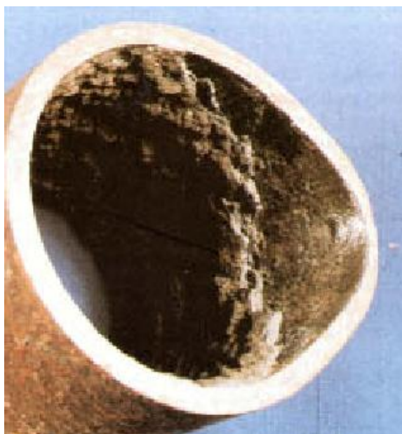
Fig. 27. Analcite formado por el arrastre de alambre de los clarificadores. Se observa como los depósitos tienden a deformar la superficie interna del tubo.
