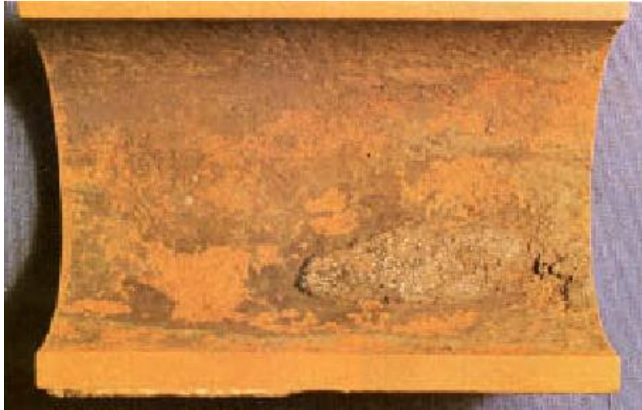
Fig. 23. Manchas de cristales de magnetita brillante asociada con los sitios de corrosión cáustica. Es frecuente encontrar estos cristales en los sitios atacados por ácidos o por la corrosión cáustica.
