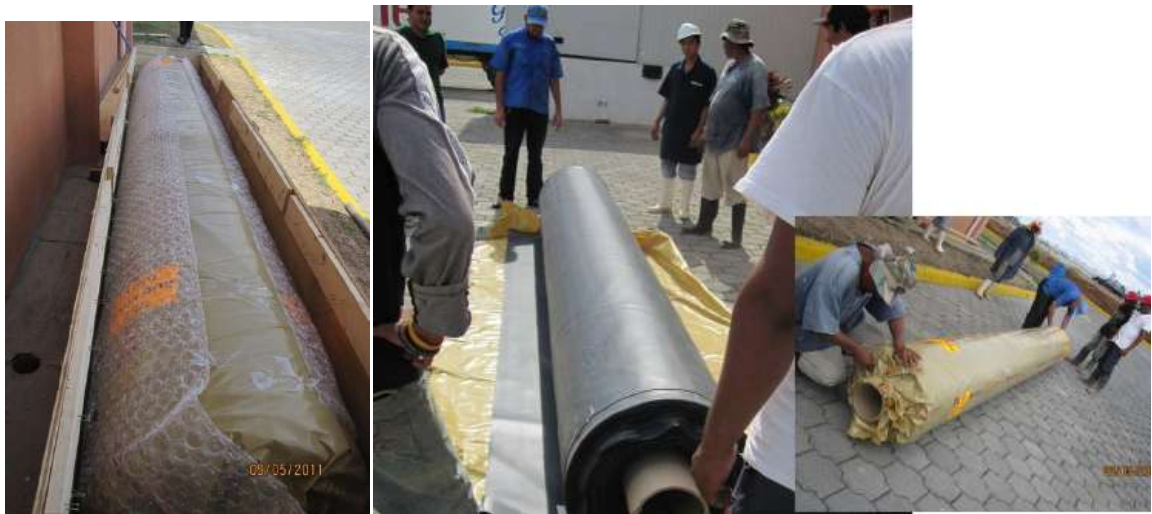
17.7 Desempacado de la Membrana Preparacion del material sobre la zona de trabajo.
