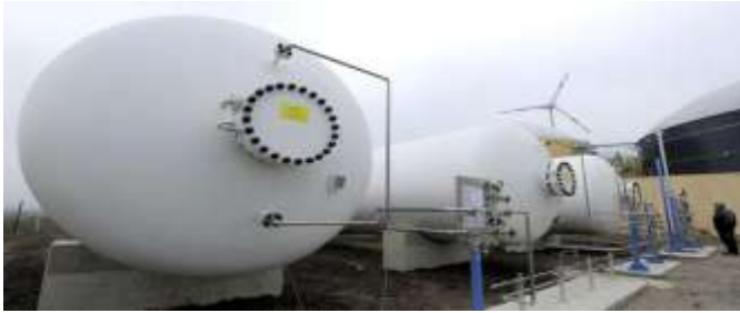
Grafico 6.7 Tanque de almacenamiento de biogás
