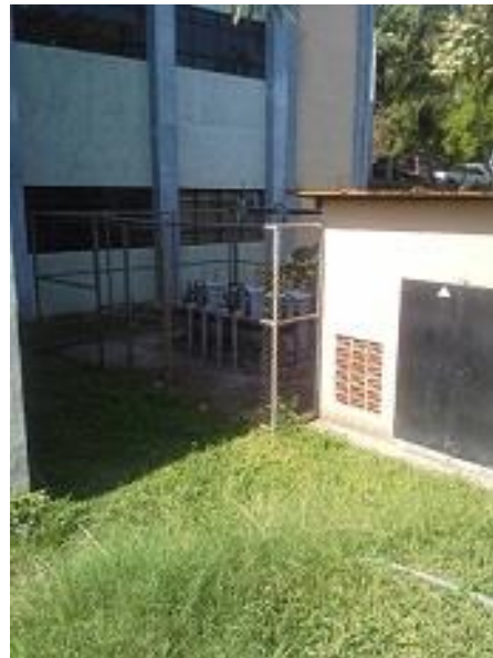
Figura 18 Ubicación geográfica de transformador 6
