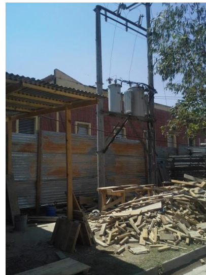
Figura 20 Ubicación geográfica de transformador 14
