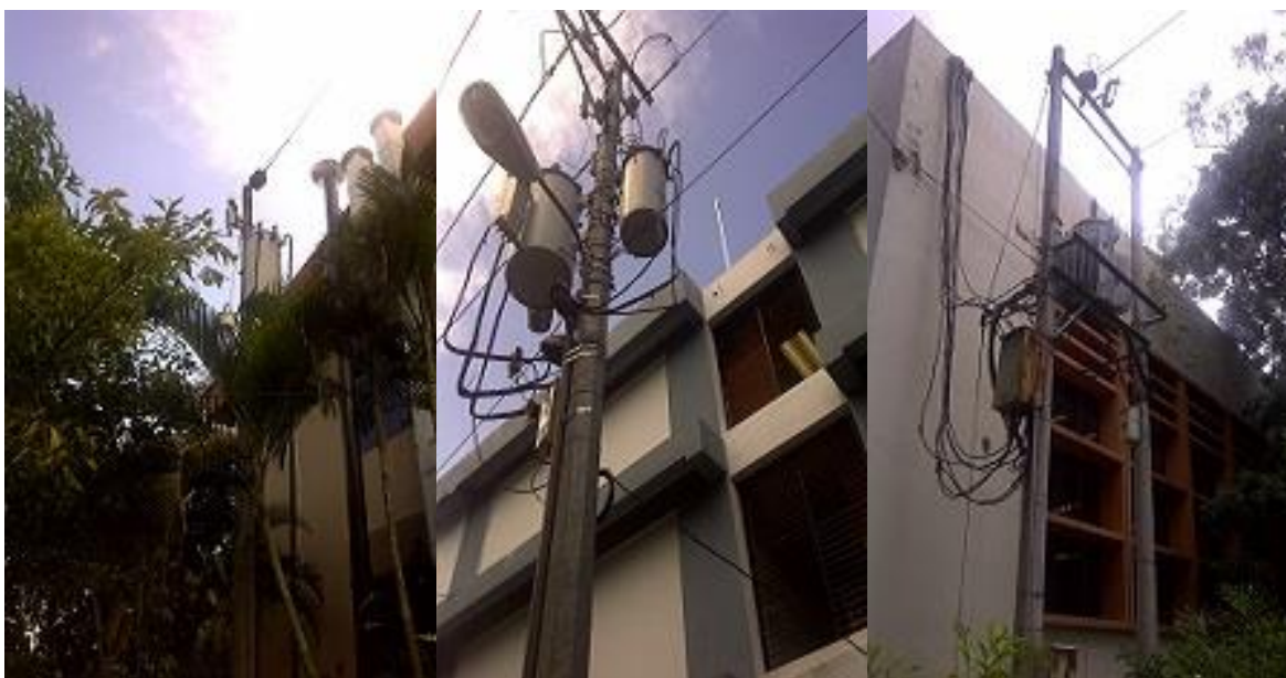
Figura 1 Red Eléctrica Aérea UES
