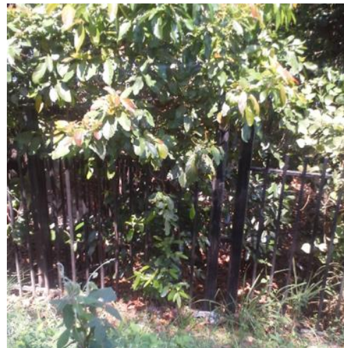
Figura 19 Ubicación geográfica de transformador 11
