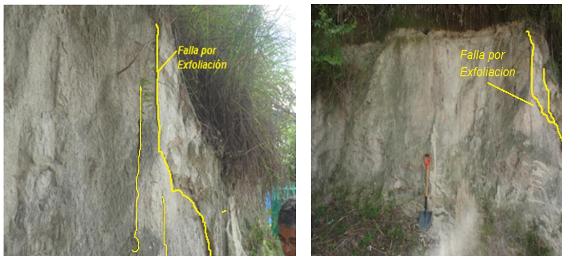
Figura No. 2.8. Mecanismo de ruptura por exfoliación de Talud ubicado en Bosques de la Paz.
