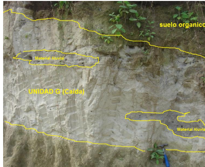
Figura No. 3.11. Talud de estrato de Unidad G de TBJ, ubicado a las afueras de Reparto Santa Marta 2.
