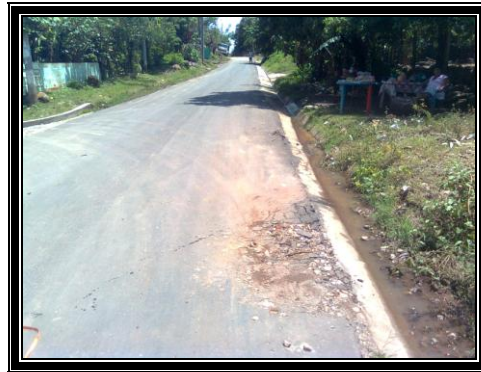
Fotografía 5.6 Daño causado por Extracción de Muestras posterior a la construcción del Tramo FUENTE: Levantamiento de Daños N° 4 (15 de Septiembre de 2010)
