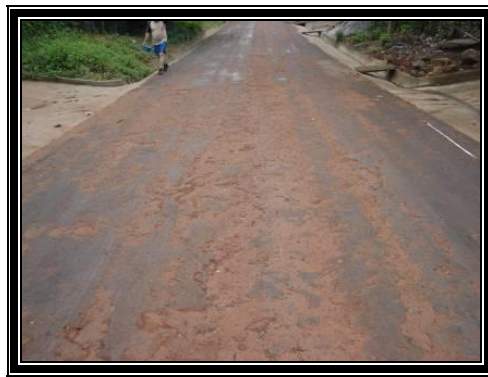
Fotografía 5.2 Desprendimiento de Capa de Aproximadamente 2 cm
