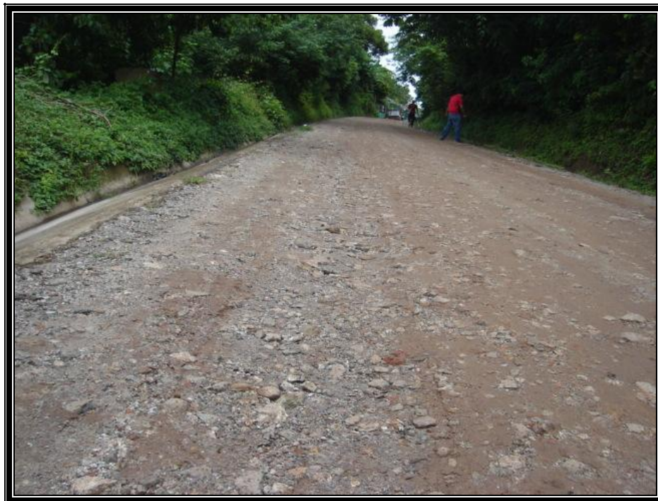
Fotografía 4.4 Pérdida de Agregado
