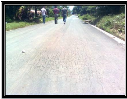
Fotografía 5.5 Piel de Cocodrilo en el Tramo Estabilizado con Emulsión Asfáltica
