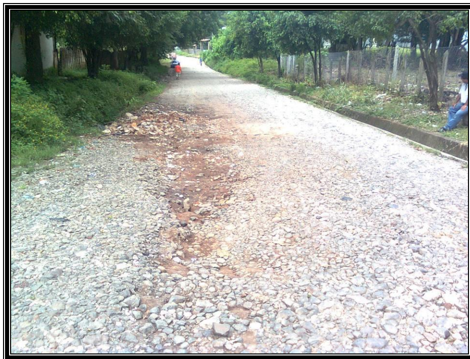
Fotografía 4.1 Sección Transversal Inadecuada
