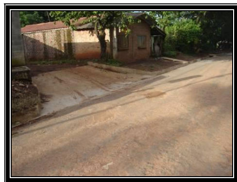
Fotografía 5.3 Baches en la Estación 0+445
