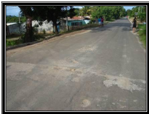
Fotografía 5.1 Empalme entre el Tramo Estabilizado con Cal+Cemento (40 m) y el Estabilizado con Emulsión Asfáltica
