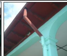
Fotografía No.144: Detalle de canchillos en alero y media caña.
