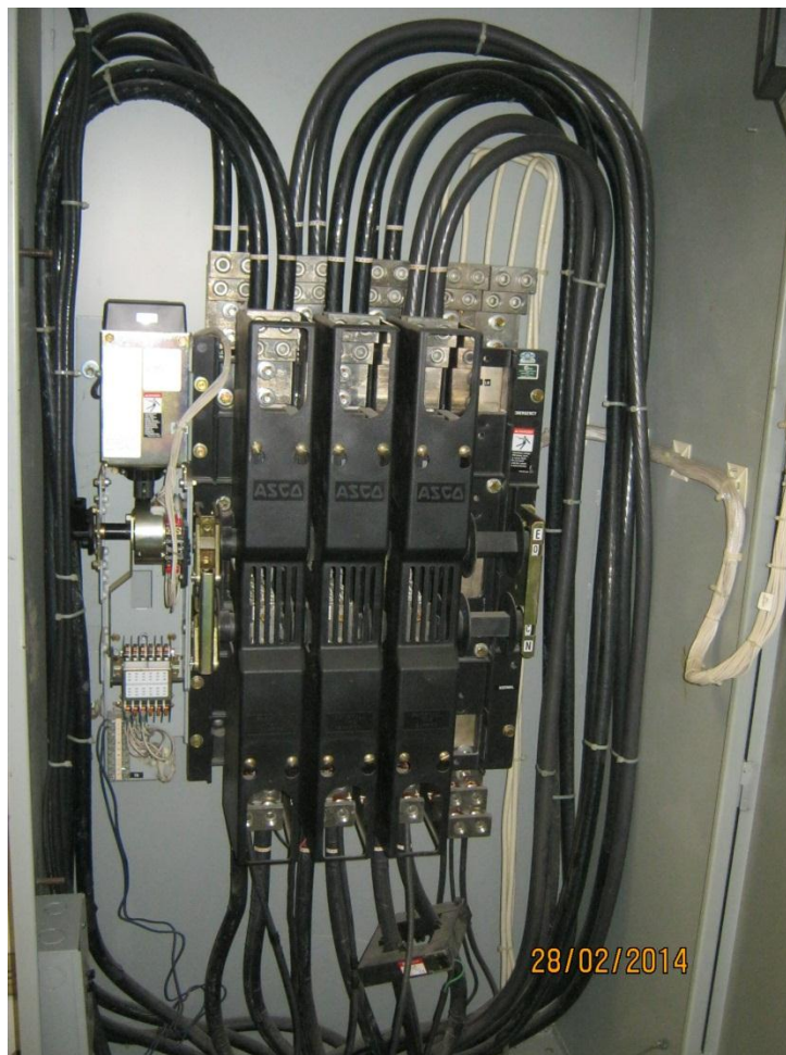
FIGURA 10 TABLERO GENERAL DE AIRES ACONDICIONADOS DEL EDIFICIO ADMINISTRATIVO.
