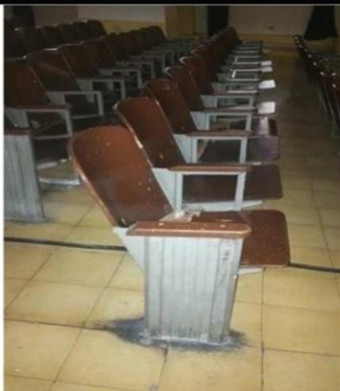
Algunas líneas de butacas se mantienen completas y en perfecto estado, por lo que sólo se hace necesario su conservación.
