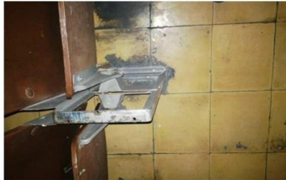
Vista de piezas faltantes en los brazos de la butaca; falta la pieza de madera contrachapada que sirve como apoyo al brazo.
