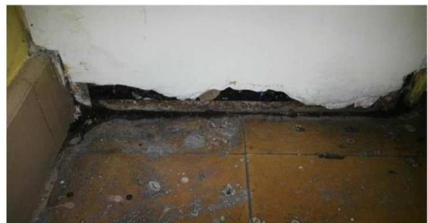
Vista de piso manchado.
