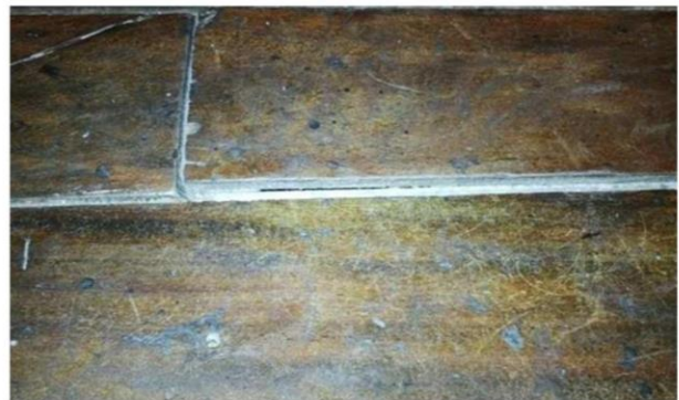
Vista de piso de madera manchada.
