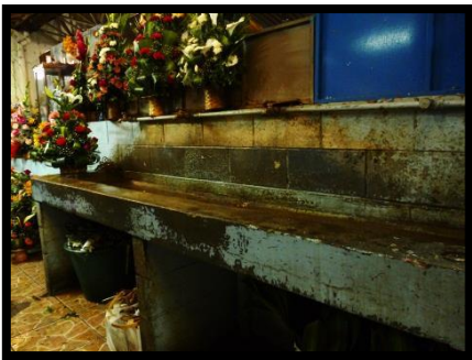
IMG.79 Puestos de flores, permanecen con mucha humedad
