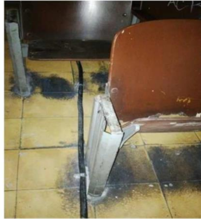
Vista de las butacas y su armazón de acero con señales de oxidación y corrosión.
