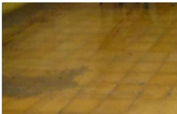
En esta fotografía se observan las manchas del piso.
