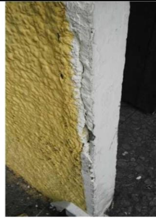
Vista de las paredes. Más que todo se observan fisuras en las esquina y grietas.
