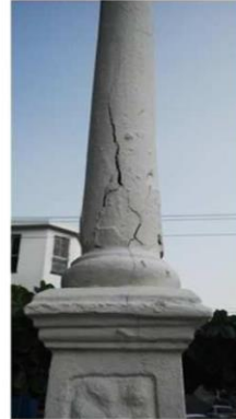
Vista de columna que presenta serias grietas.
