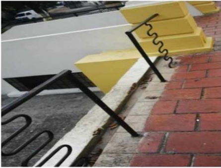
Vista de los pasamanos al exterior donde se observan piezas faltantes que han sido cortadas.
