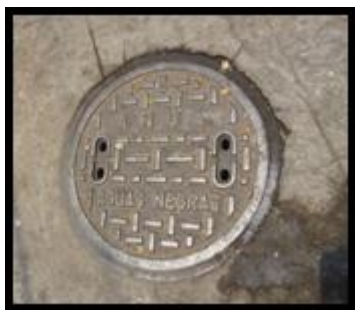
IMG.26 Pozo de Aguas Negras sobre la 2da Av. Nte.
