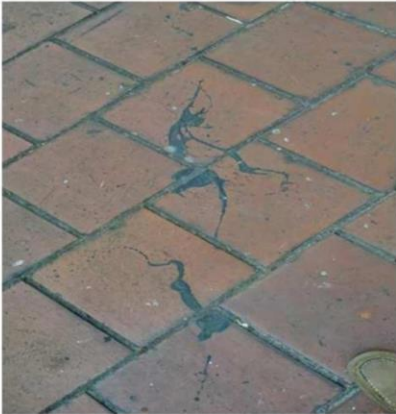
Vista del piso del exterior, el cual se encuentra manchado.
