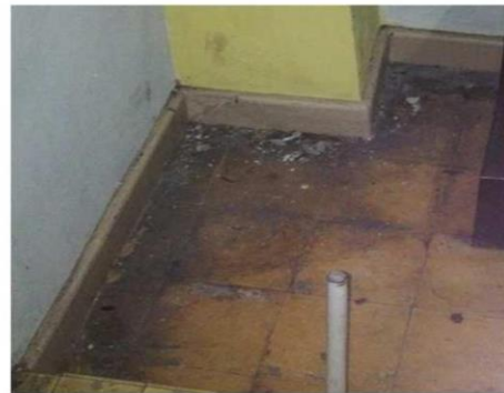
Vista del zócalo de concreto fisurado y tramos faltantes en algunos casos.
