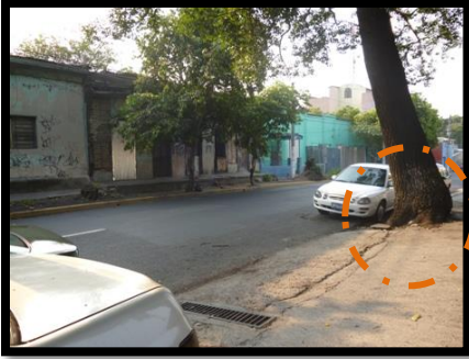
IMG.99 Árbol ubicado sobre la Avenida España, las raíces han levantado el pavimento
