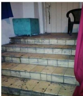
Vista del otro extremo de las gradas el cual presenta manchas.
