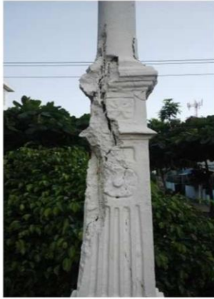
Vista de la columna en un deterioro avanzado. Ha perdido una parte de su estructura debido al agrietamiento.
