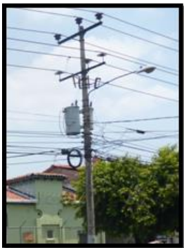
IMG.24 Poste de energía eléctrica sobre 29 Calle Pte.
