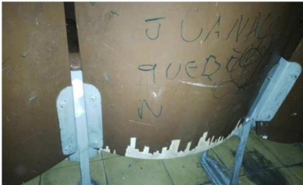
Vista de las butacas manchadas con grafiti y con descascamiento avanzado.
