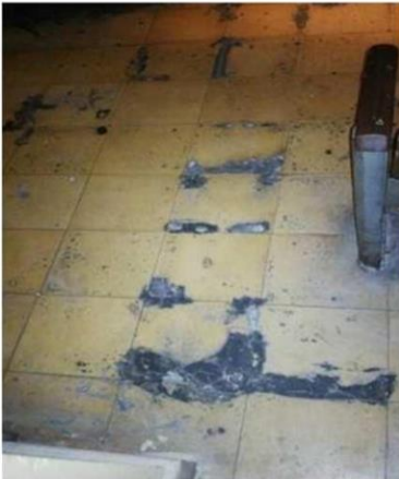
Fotografía del piso ubicado en el área del Auditorio en el que se observa el piso manchado.
