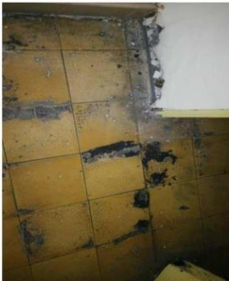
Aquí se muestra que el piso presenta una capa de lodo, además de las manchas.
