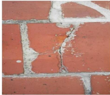
En esta fotografía se observan pequeñas grietas en el piso.
