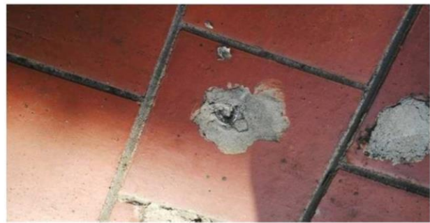
En esta fotografía se observa que se le ha querido dar tratamiento al piso rellenándolo con cemento.
