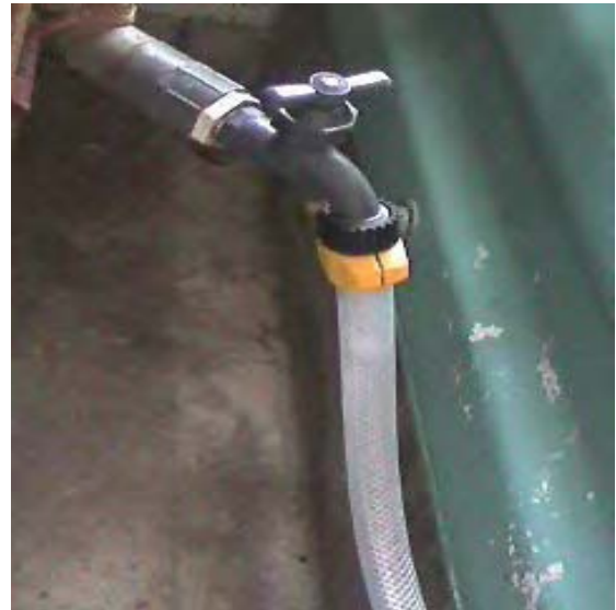
Fotografía 19. Manguera del dispensador de agua desmineralizador .
