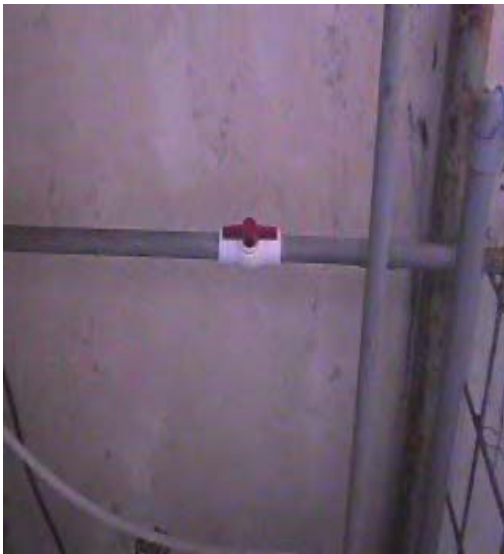
Fotografía 18. Válvula de bola.
