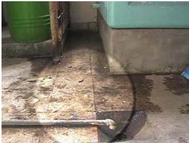
Fotografía 2. Fuga de agua.
