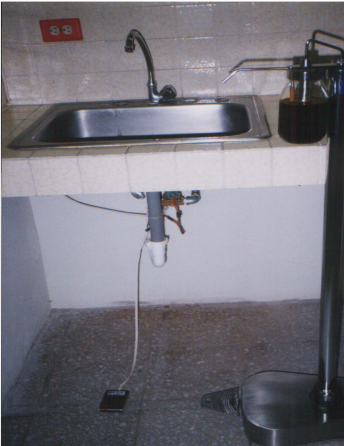
LAVABO DE ACERO INOXIDABLE CON PEDAL PARA DISPENSAR AGUA Y DISPENSADOR DE SOLUCION DE YODO PARA LAVADO DE MANOS
