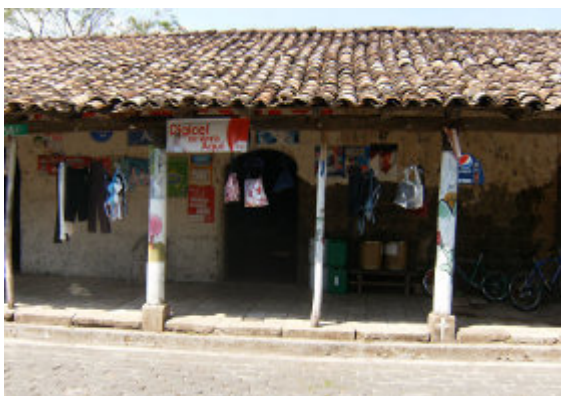
Imagen 18- Condición actual del portal Norte sobre calle San José Fuente: Propia del investigador
