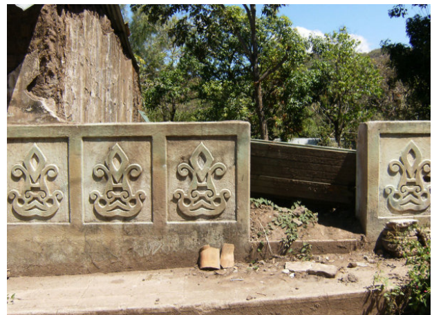
Imagen 39 - Relieve elaborado en repisa de vivienda en Jocoaitique actualmente en ruina
