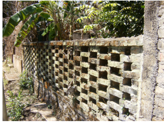
Fotografía # 116 Vivienda con Muros decorativos en completo deterioro
