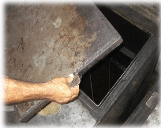
Tanque de almacenamiento.
