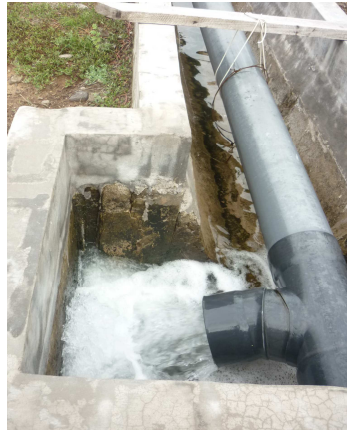
Figura 12. Compuerta abierta para llenado de estanque.
