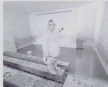
Ramón Rivas muestra la inundada sala de exposiciones de San Andrés. Las filtraciones de agua continúan.
