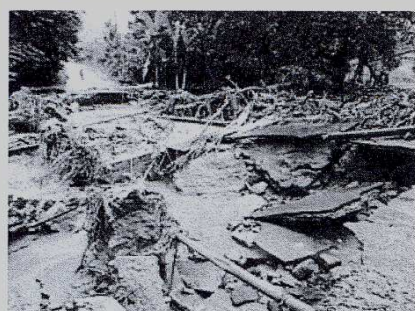
Este tramo de la carretera San Salvador-Ciudad Arce quedó totalmente afectado por las lluvias.
