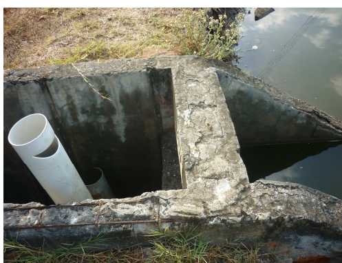
Figura 15. Compuerta de entrada a estanque de agua nueva.
