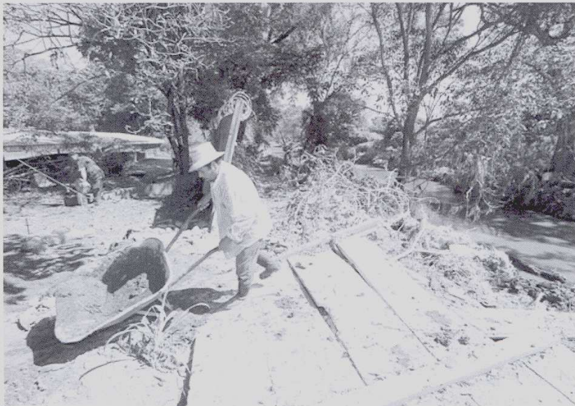
El parque San Andrés fue el más afectado por las aguas del río Sucio, que lo bordea. Dos años podrían tardar las obras de reparación, aunque el sitio estaría abierto al público en los próximos días, solo con acceso a las pirámides. FOTOS: EDH / CORTESÍA SEC
