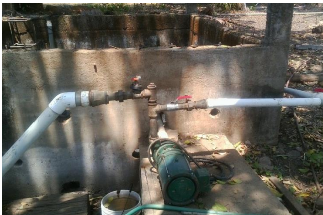
Ilustración 25 Pozo y bomba para el sistema de riego por goteo
