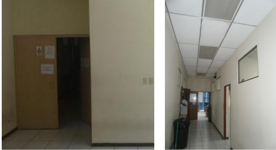
Figura 32: Puertas del pasillo oriente y de cada oficina que debe estar cerrado para evitar el ingreso de aire caliente.
