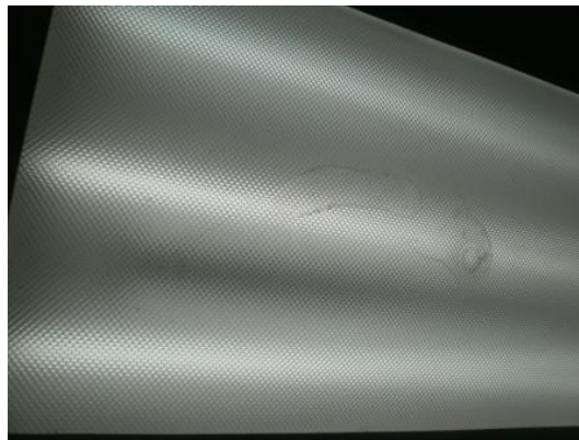
Figura 49: luminarias obsoletas con tres tubos de 40 W y pantallas sucias.
