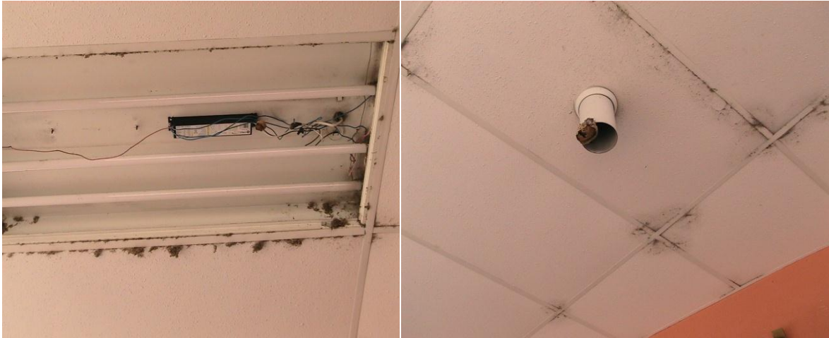
Figura 9: Falta de Mantenimiento de luminarias.
