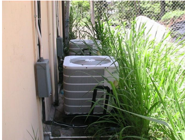
Figura 10: Falta de mantenimiento de Unidades compresoras.
