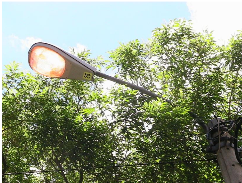
Figura 8: Luminaria encendida a plena luz del día.
