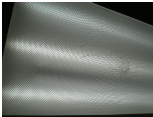
Figura 36: luminarias obsoletas con tres tubos de 40 W y pantallas sucias.
