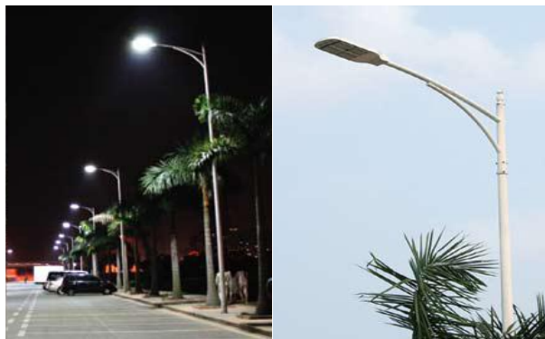
Figura 3: Iluminación LED exterior LU4.
