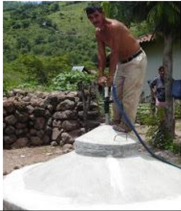
Fotografía F5.5k Bombeo manual hacia tanque
