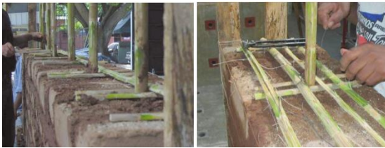
Fotografía F5.5d (a) Colocación del refuerzo horizontal, perpendicularmente al eje longitudinal de la pared, alrededor de los refuerzos vertical, (b) amarre del refuerzo horizontal con el refuerzo vertical.
