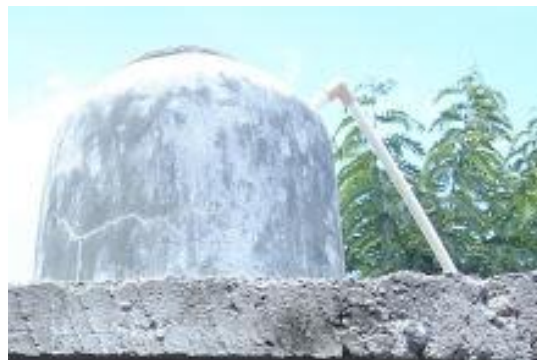
Fotografía F5.5j Tanque elevado de ferrocemento
