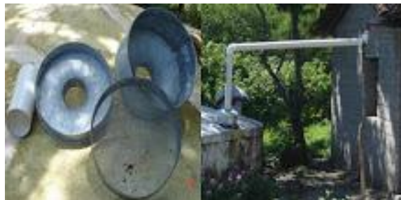
Fotografía F5.5i Filtros de captación.
