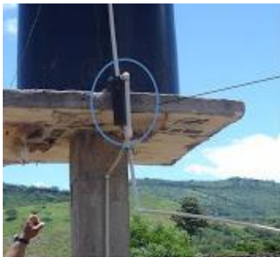
Fotografía F5.5L Filtro de salida del tanque aéreo
