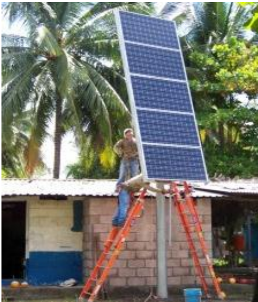
Fotografía F5.5g Utilización de paneles solares en el Centro Escolar Cantón el Cordoncillo, del Municipio de San Luis la Herradura.
