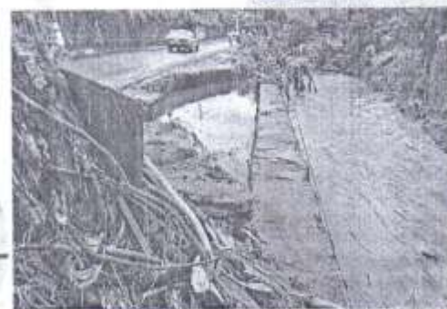
EN LA ZONA DONDE CAYÓ EL BUS no se hicieron obras de mitigación por lo tanto quedó desprotegida. Ayer se abrió un boquete a la orilla de la calle.
