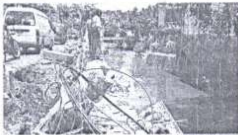
EN LA CALLE DE MONTSERRAT, es imprescindible construir obras de control de drenaje para evitar que el caudal del Arenal vuelva a salirse de su cauce.
