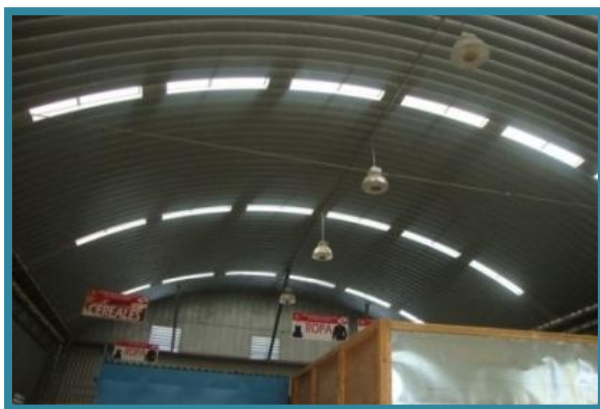
Fotografía N° 52 Iluminación en la cubierta del techo.
