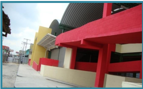
Fotografía N° 55 Perspectiva de rampa en la Fachada Principal sobre la 6ª Calle Oriente
