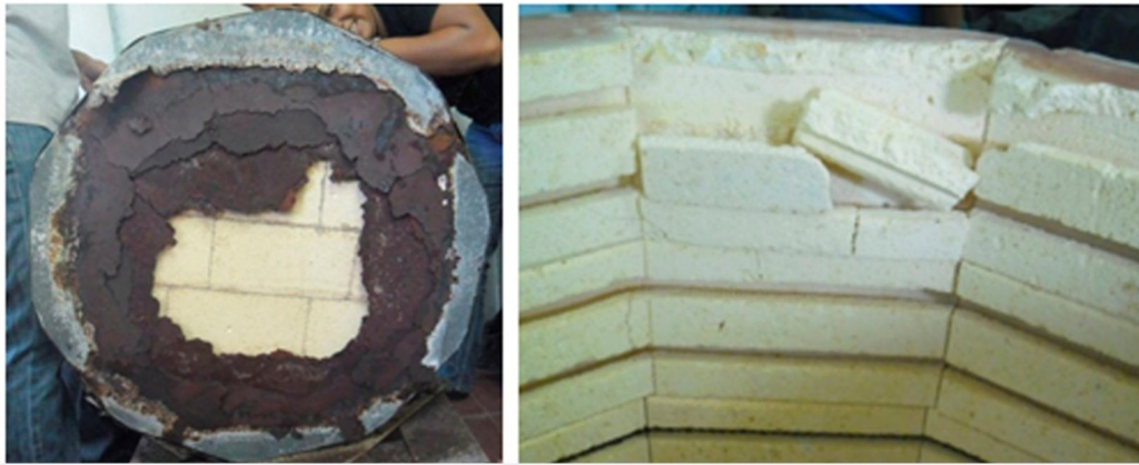
Estado de conservación de la base del horno eléctrico y Estado de conservación de paredes internas (cuerpo refractario)
