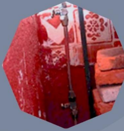
Vista de los llaves o reguladores
