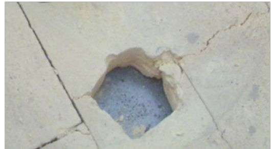
Perforación realizada en el piso del horno
