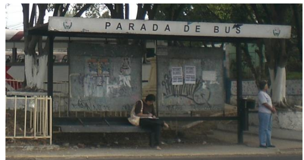
Foto 60. Parada de autobuses plaza del Oratoriano, estas se encuentran en mal estado.
