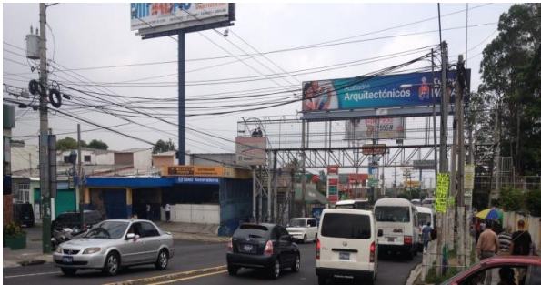
Foto 85. Postes de telefonía sobre área comercial.
