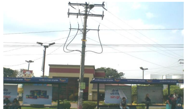
Foto 84. Postes de Alta Tensión de energía eléctrica sobre aérea comercial
