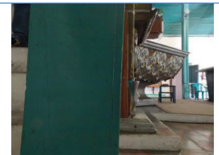
CÓDIGO: 113 DAÑO: DESAPLOME
