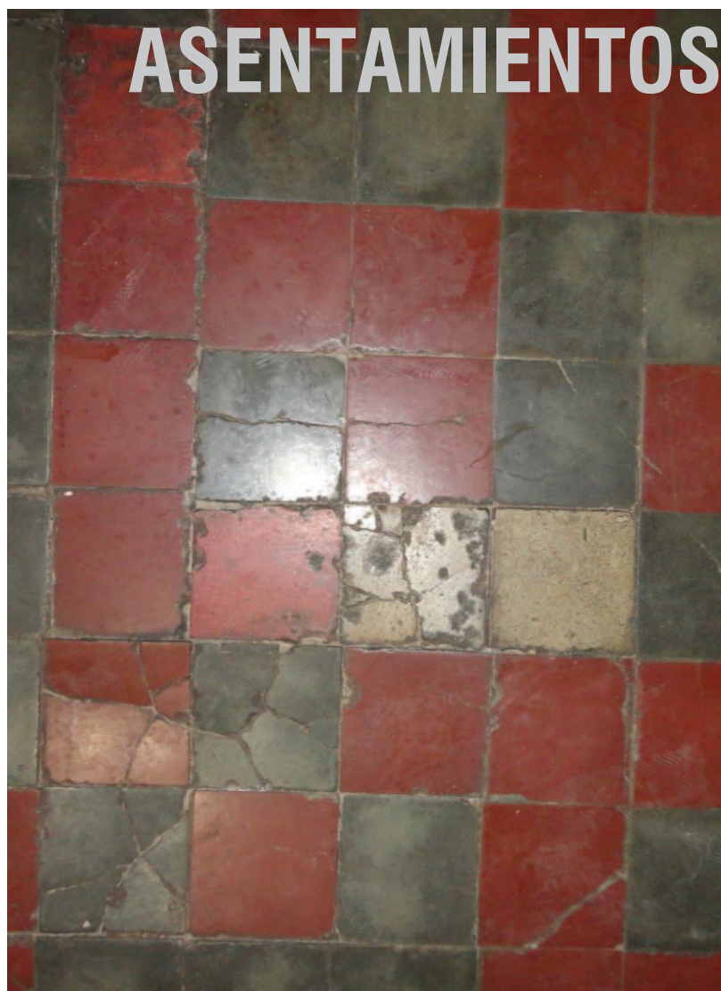
Asentamiento de piezas de piso de la casa parroquial
