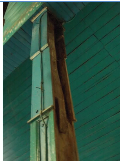
CÓDIGO: 109 DAÑO: FALTANTE
