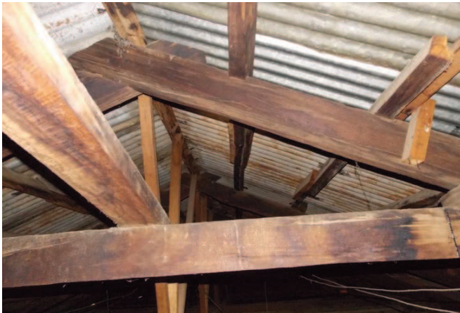
Imagen N°9.1 Estructura y cubierta en nave central de Iglesia San Jerónimo Dr. Mantenimiento preventivo en techos
