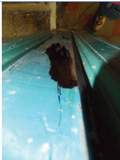
CÓDIGO: 108 DAÑO: FALTANTE
