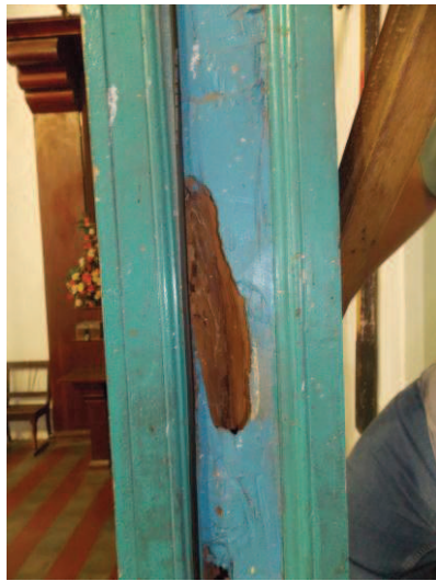
CÓDIGO: 106 DAÑO: FALTANTE
