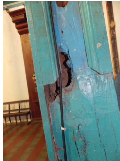
CÓDIGO: 107 DAÑO: FALTANTE
