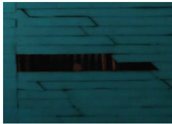
CÓDIGO: 116 DAÑO: FALTANTE
