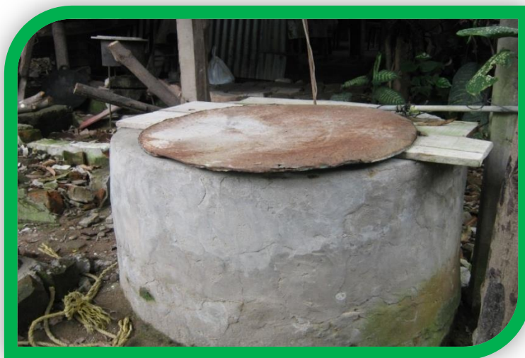
Figura N° 1: Tapadera no adecuada del pozo.
