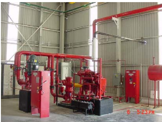
IMAGEN: 131 EQUIPO CENTRAL CONTRA INCENDIO
