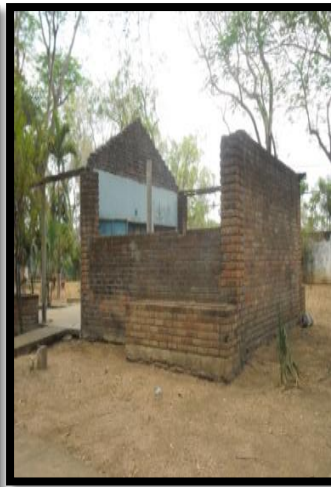
Una estructura que sirvió como cafetín pero solo queda paredes.
