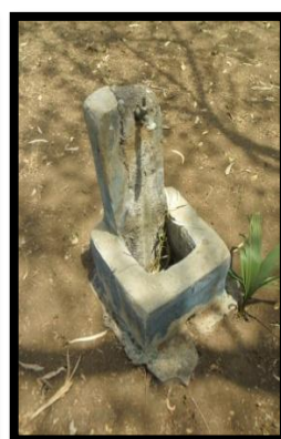
Bebedores en mal estado.
