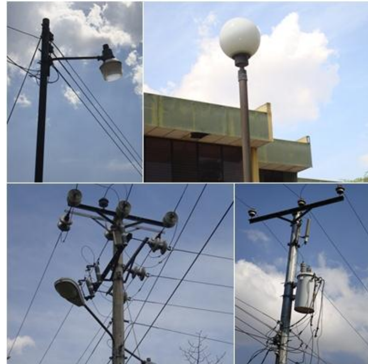
Imagen N° 34 Postes de energía y luminarias
