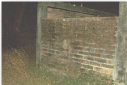
Fig. 29 Muro que delimita el Rastro con el Exterior
