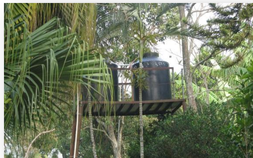
Fotografía # 68 Tanque de plástico para agua potable.
