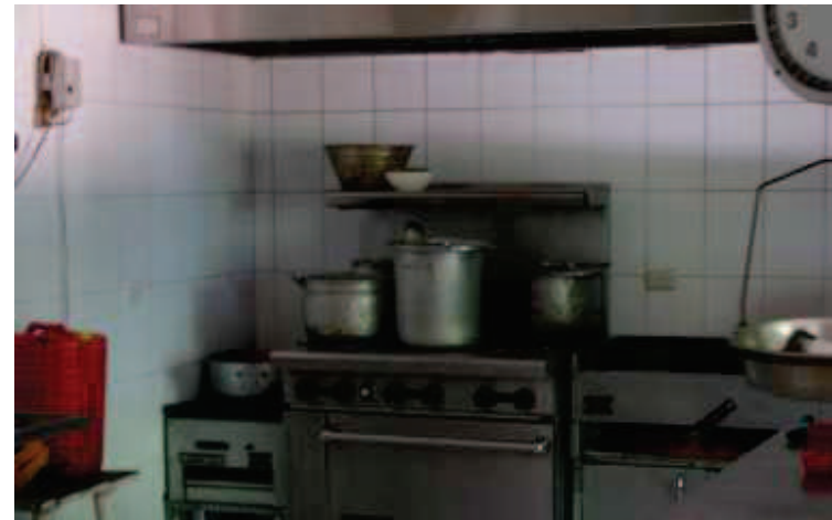
Fotografía N°37 Cocina, horno y plancha en el interior de la cocina
