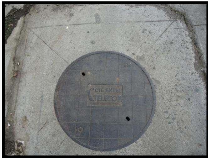
Caja distribuidora de telefonía img. 26
