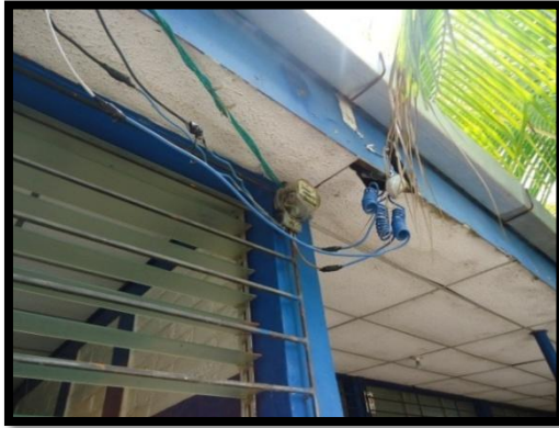
Cables eléctricos a la intemperie img. 38
