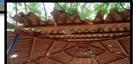
Kiosco en mal estado img. 56
