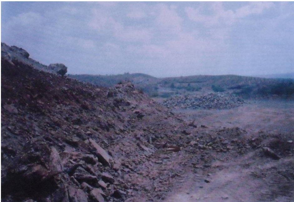
Figura 3.6.4. Área erosionada debido a la escorrentía de las aguas lluvias.
