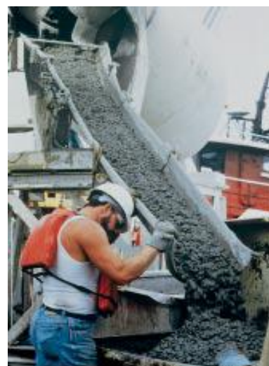
Fig. 2.5. El concreto de buena trabajabilidad debería fluir lentamente hacia el lugar, sin segregación.
