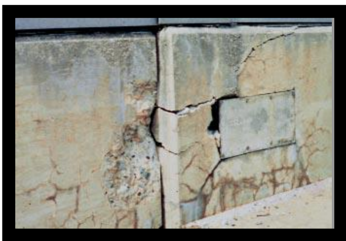
Ilustración 21 Fig. 1.21. La figuración, el cerramiento de las juntas y la dislocación lateral fueron causados por la severa reactividad álcali-agregado en este muro de parapeto.
