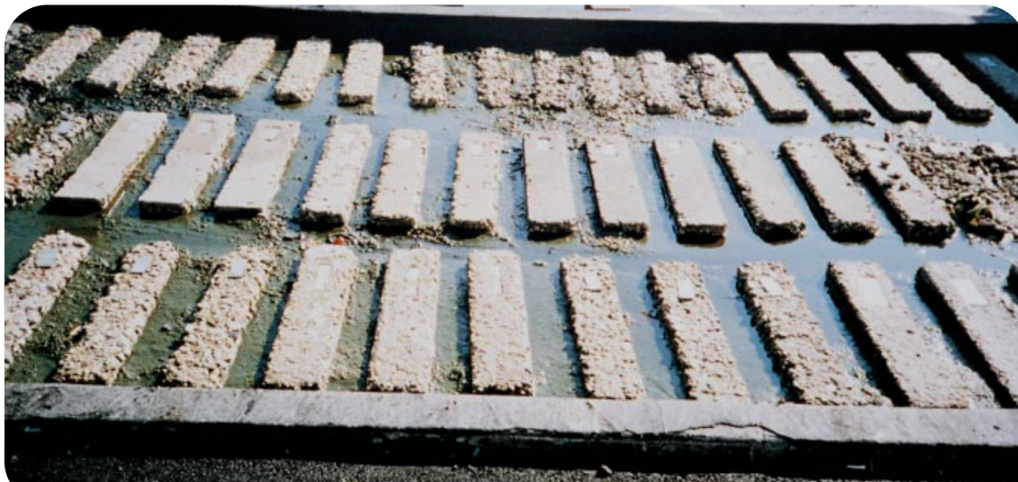
Ilustración 24 Fig. 2.24 Vigas de concreto después de muchos años de exposición a un suelo con alta concentración de sulfatos en Sacramento, California, terreno de ensayo. Las vigas en mejores condiciones tienen bajas relaciones agua-materiales cementantes y muchas de ellas tienen cemento resistente a sulfatos. La foto menor, a la derecha en la parte superior, enseña dos vigas inclinadas sobre sus laterales para mostrar niveles decrecientes de deterioro con la profundidad y el nivel de
